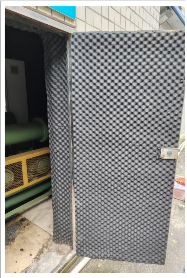
污水站设备间隔音措施
