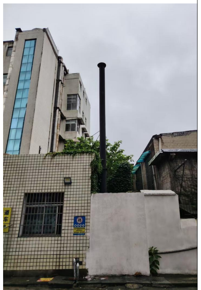
天然气锅炉排气筒
