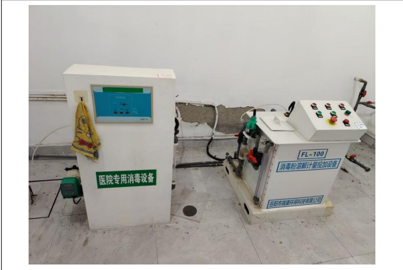
综合污水站消毒设备
