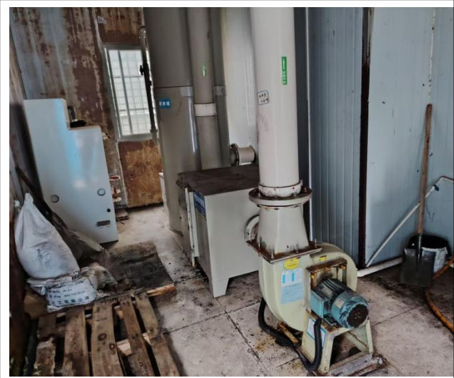
污水站臭气处理系统
