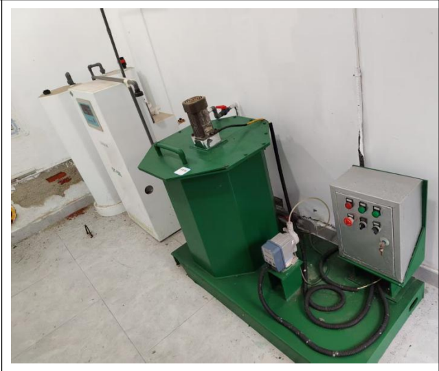
传染科污水预处理消毒设备
