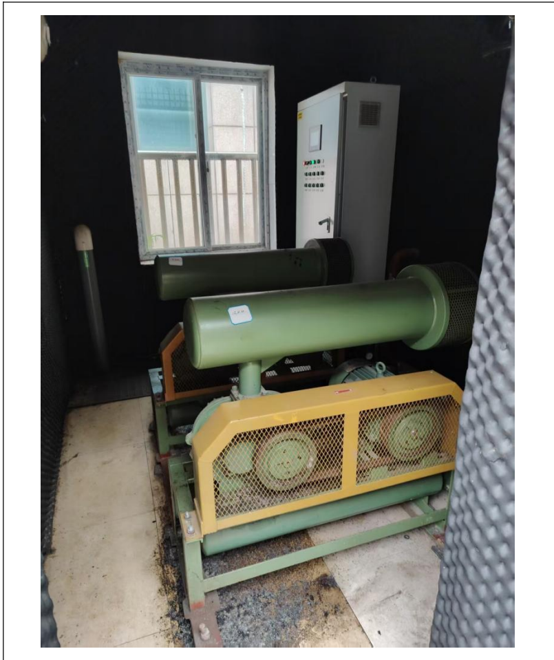
污水站设备间
