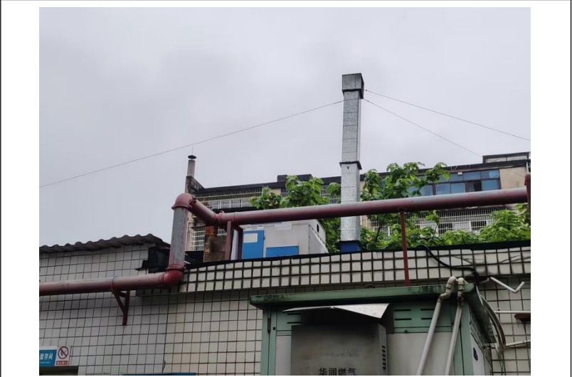
危废间废气处理设备
