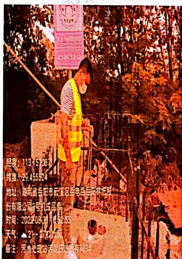
污水处理站污泥压滤暂存间 3#井
